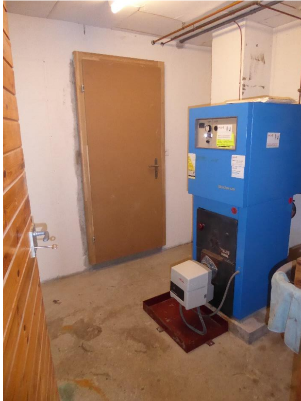
Chaudière à mazout
