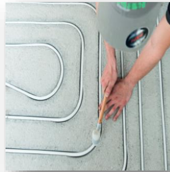
Chauffage de sol avec fraisage
